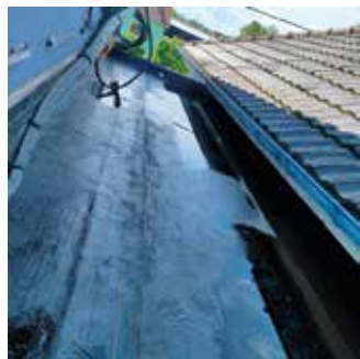
Avant travaux, des fuites étaient constatées sur la toiture plate
