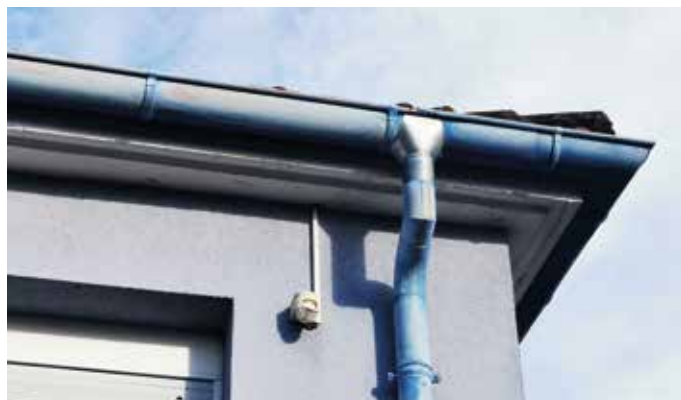
Une gouttière avant travaux
